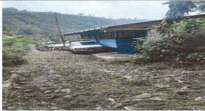
Foto 1: Sustitución de lámina, colocación de canales, bajadas de agua y pintura de muros interiores y exteriores de módulo II.
